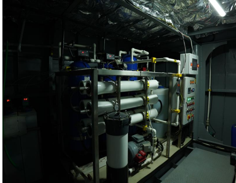
RO ve su arıtma sistemi – operasyonel iç yapı
